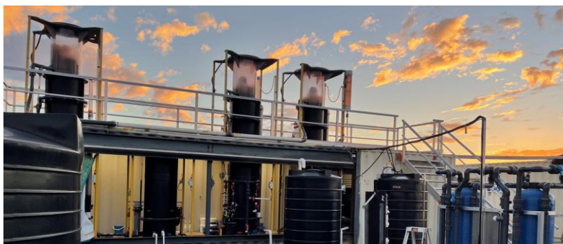
PFAS 1125 WTP onsite
