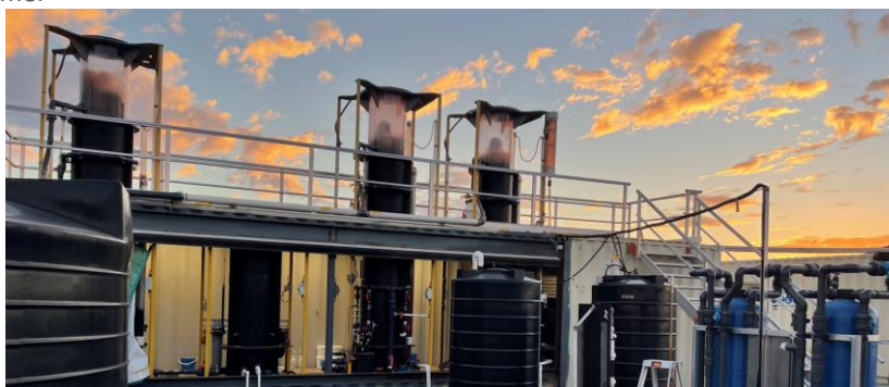
PFAS 1125 WTP onsite
